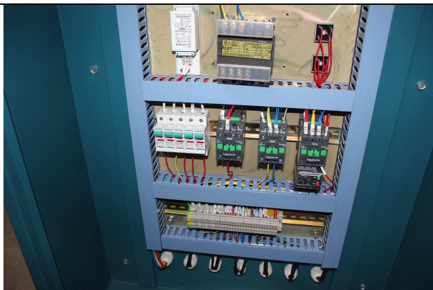
Стенд 04К(М),04К Автоматика Schneider
